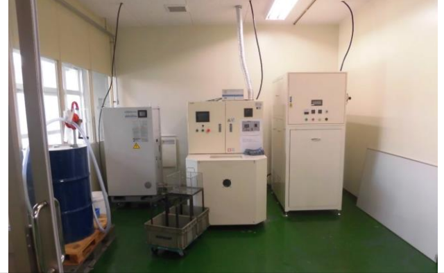
非化学物質系の洗浄設備
